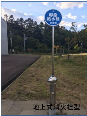
余市川浄水場 応急給水栓
