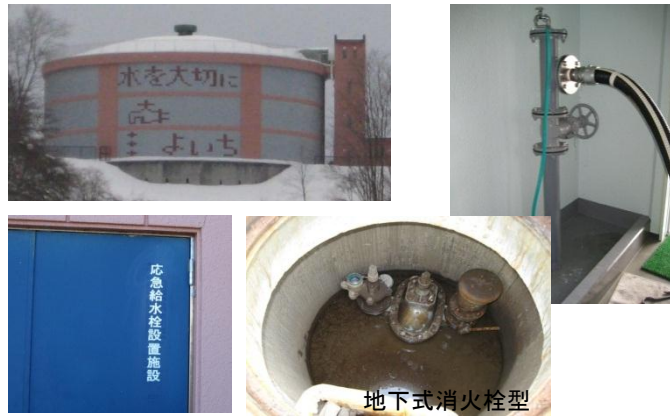
朝日 2 配水池 応急給水栓
