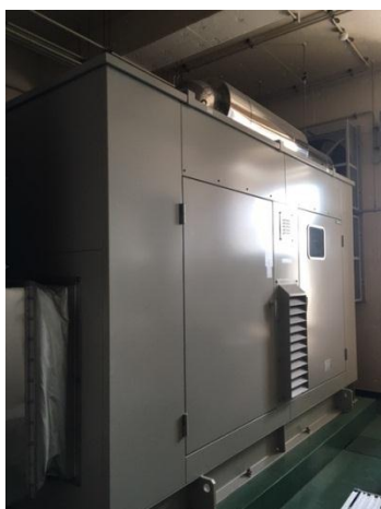
非常用発電機(余市川浄水場)
