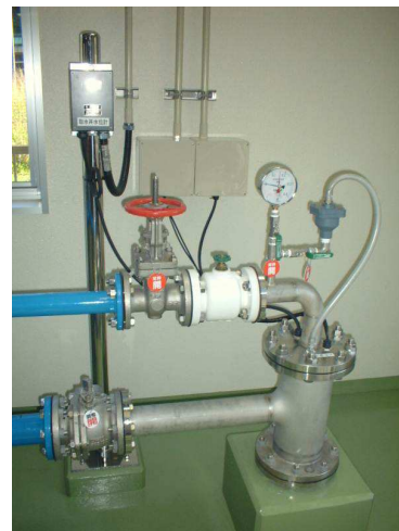
【栄地区浄水場内にある井戸水源】
