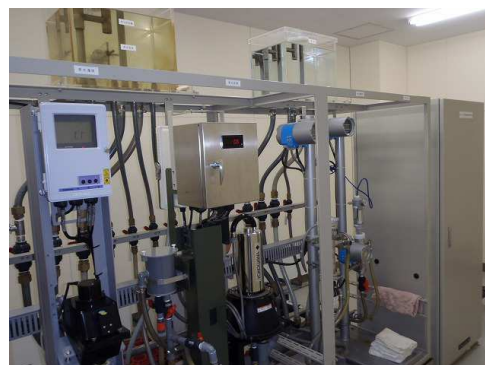
【余市川水源水質自動監視装置】
